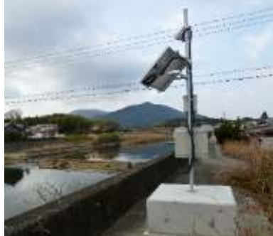
簡易型河川監視カメラ （三重県）
