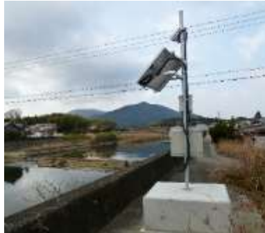
簡易型河川監視カメラ （三重県）
