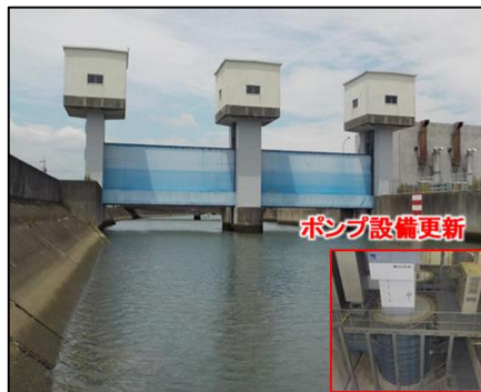
堀切川排水機場延命化対策事業 （ポンプ設備更新）（三重県）
