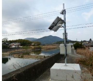
簡易型河川監視カメラ （三重県）
