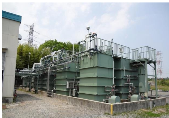
汚染地下水を浄化する水処理施設
