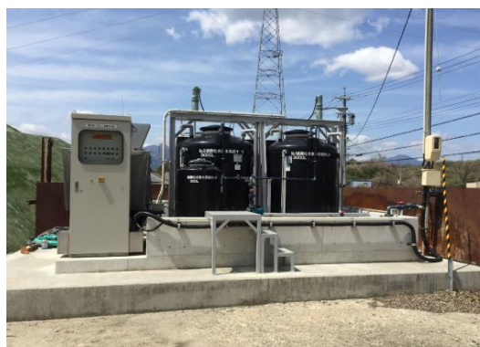
ガス発生抑制のための酸化剤注入装置
