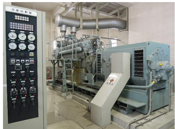
更新予定の多気浄水場（多気町） 非常用発電設備
