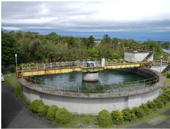
耐震設計予定の伊坂浄水場（四日市市） 排水処理施設
