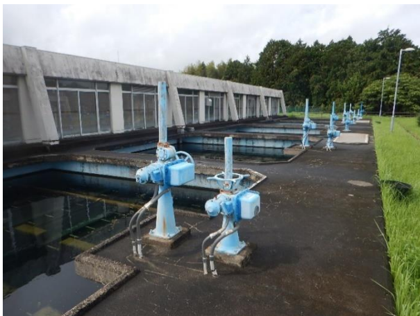
更新予定の高野浄水場（津市） 急速ろ過池電動弁
