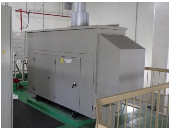
更新予定の桑名加圧ポンプ所（桑名市） 非常用発電設備
