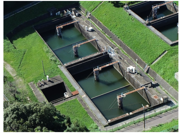
耐震設計予定の山村浄水場（四日市市） 排水処理施設
