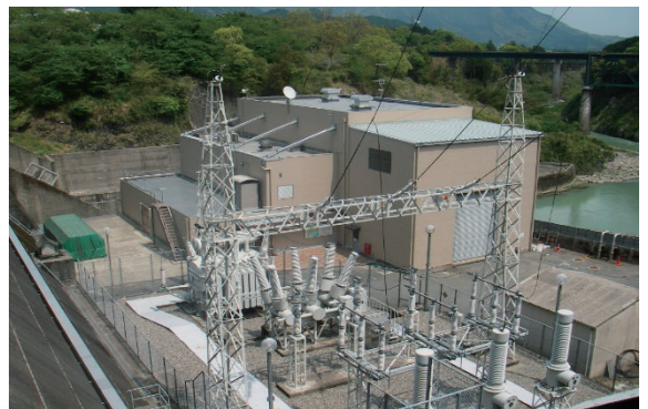
三瀬谷発電所
