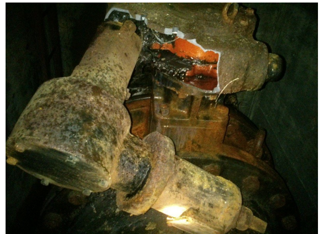
図-13 破損した制水弁
