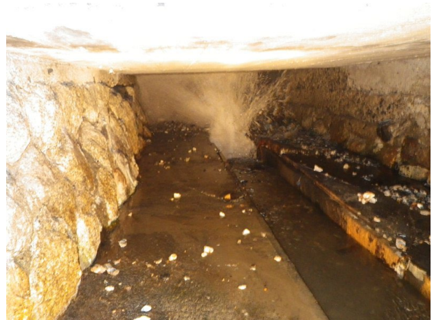
図-5 漏水の状況
