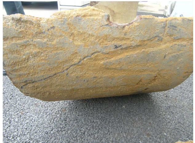
図-15 撤去された配水管 (凹部)
