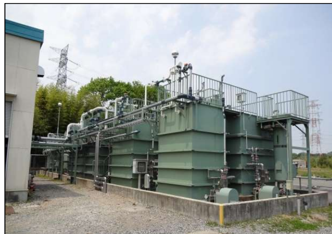
汚染地下水の水処理施設
