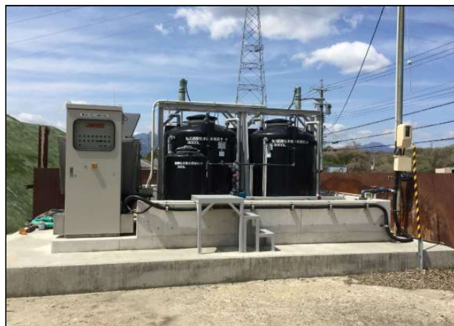
霧状酸化剤注入装置
