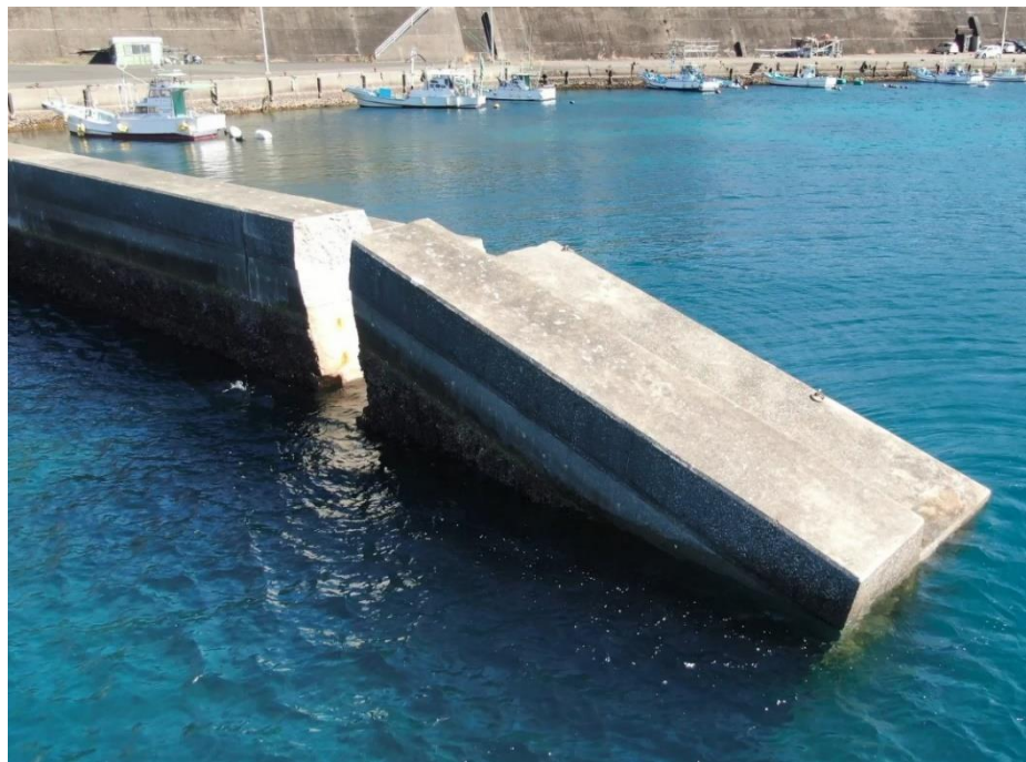
波浪により破損した防波堤
