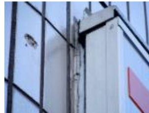
コーキングが劣化した状態
