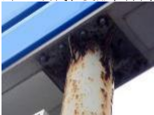
接合部（溶接部）が腐食している状態
