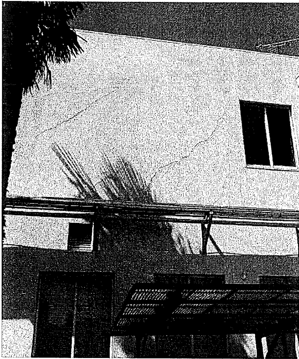
外壁の大きな亀裂
