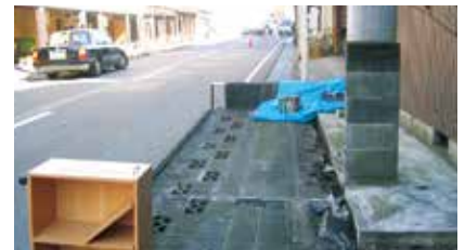
倒れたブロック塀
