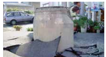
突き出したマンホール
