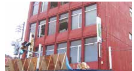
破損、落下した窓ガラス
