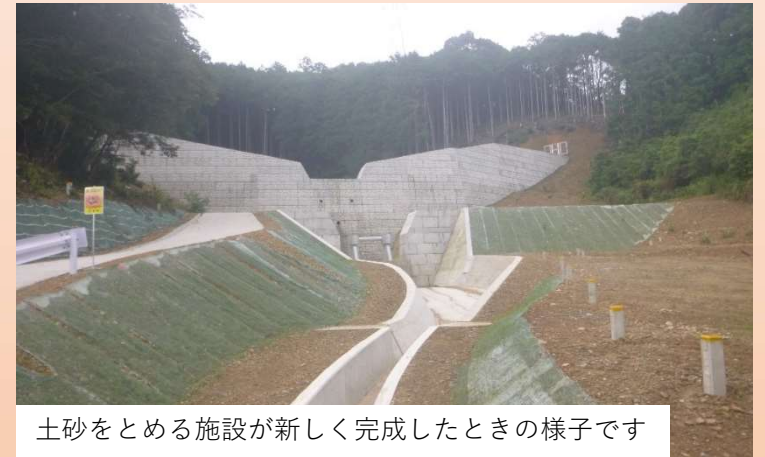
上流から流れてくる大きな木や石をとめて、下流の安全を守る施設です
