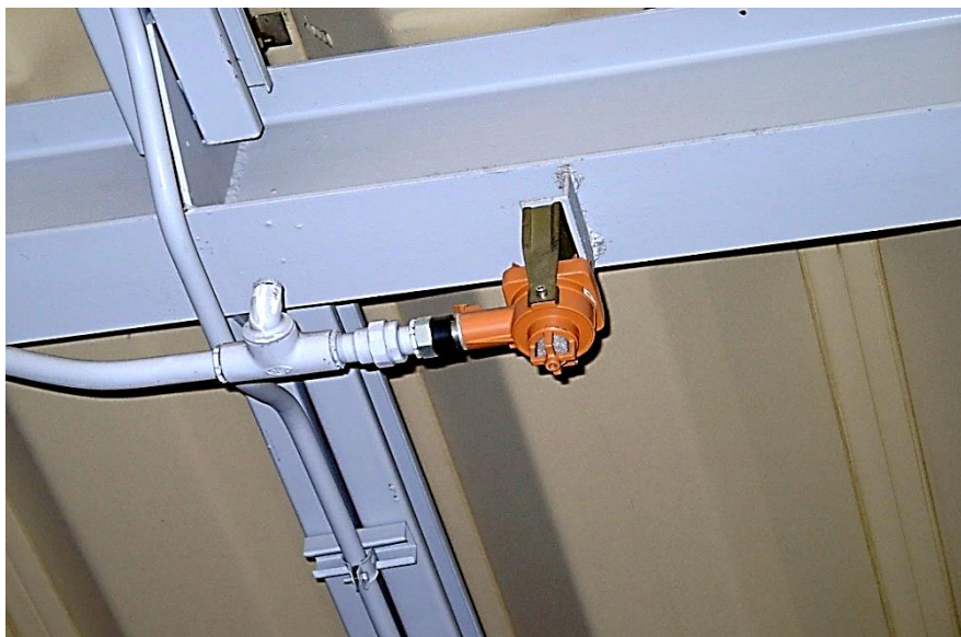
可燃性ガス漏えい検知部
