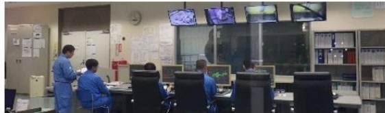
三重ごみ固形燃料（RDF）発電所 運転停止操作
