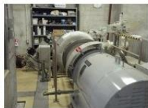
宮川ダム維持放流発電設備
