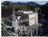
三瀬谷発電所
