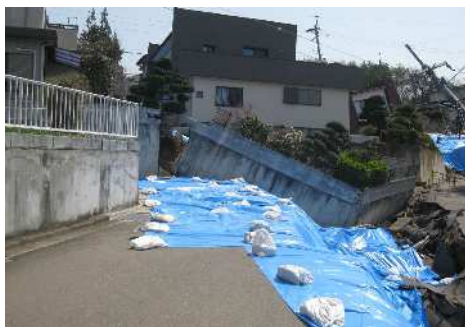
(c)腹付け盛土の崩壊
