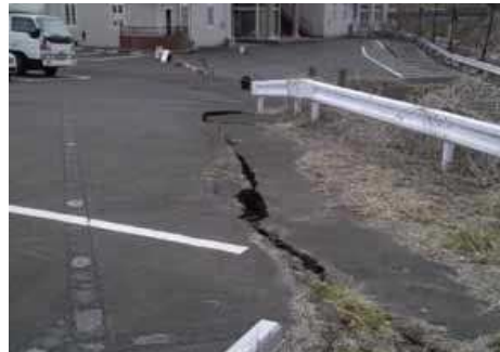
(b)のり肩の亀裂
