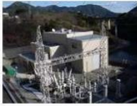
三瀬谷発電所
