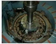
青蓮寺発電所
