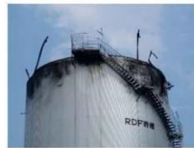
三重ごみ固形燃料 RDF貯蔵槽
