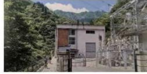
宮川第三発電所
