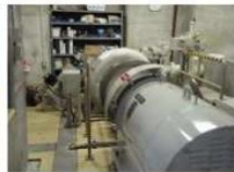
宮川ダム維持放流発電設備
