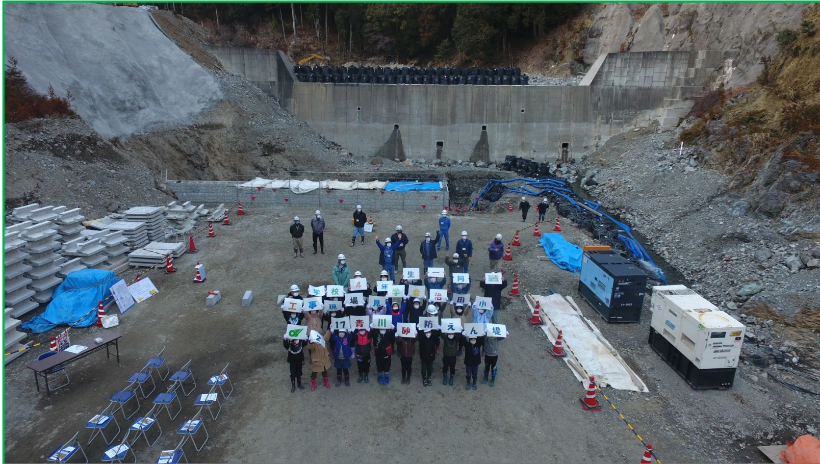
青川国補通常砂防（1号堰堤前庭保護工）工事現場をバックにして記念撮影 【現在小学4年生の皆さんの後ろにあるのが現在工事中の砂防堰堤です。】
