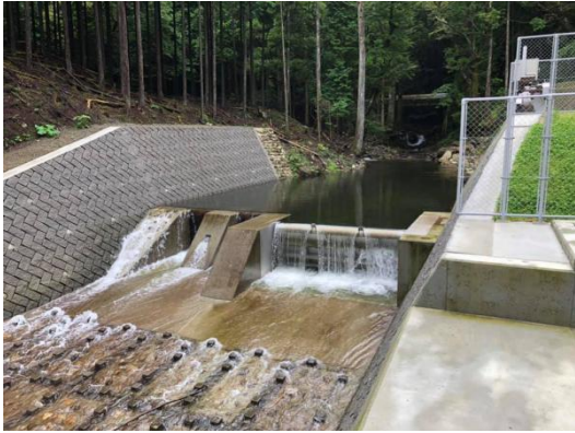
＜馬野川小水力発電施設（取水口）＞
