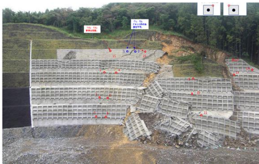
法面崩壊状況
