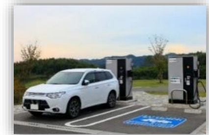
電気自動車と充電ステーション
