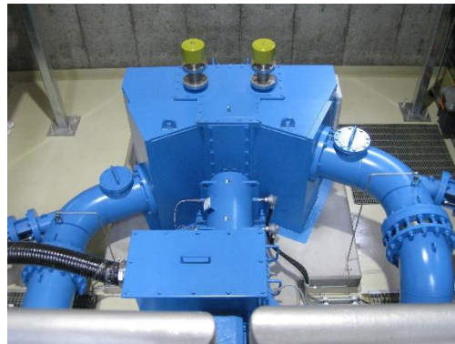
写真：馬野川小水力発電所（伊賀市）
