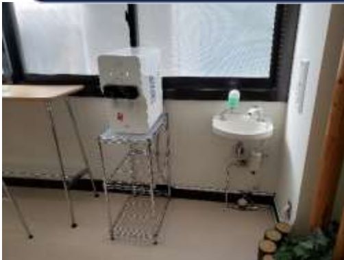
県庁厚生棟地下1階に設置
