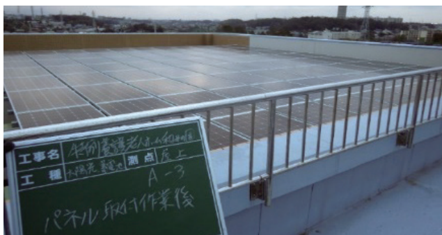
和みの園の屋上に設置された太陽光パネル
