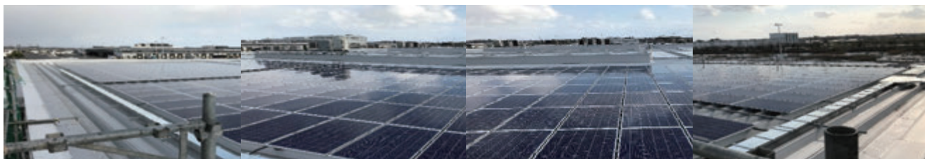
太陽光パネル
