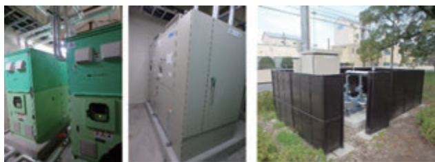
ヒートポンプユニット
