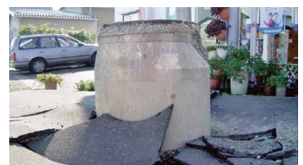
突き出したマンホール
