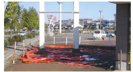
落下した屋外看板
