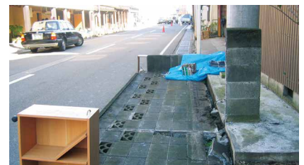
倒れたブロック塀
