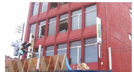
破損、落下した窓ガラス
