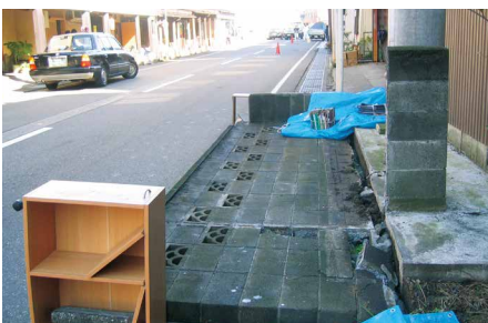
Muro de blocos tombado
