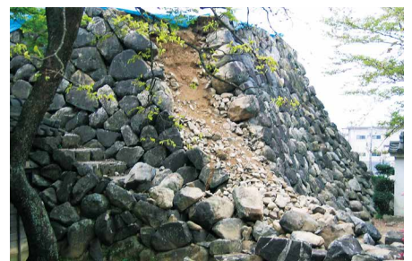
Parede de pedra desabada
