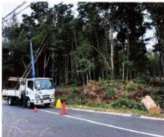
危険木の除去事業 自治会による危険木伐採の様子
