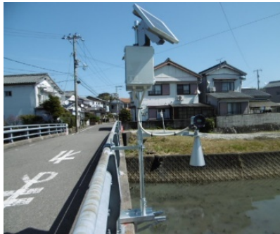
危機管理型水位計 （三重県）
