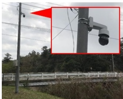
危機管理型水位計 （菟野町）
