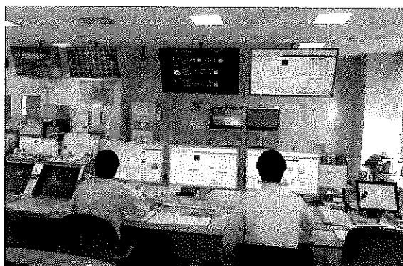
高野浄水場中央監視の状況
