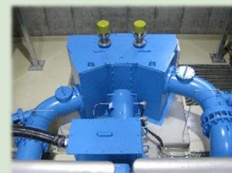
(小水力発電設備)
