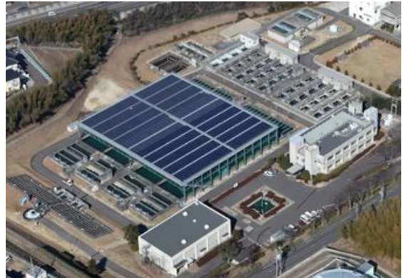
太陽光発電設備（播磨浄水場）
