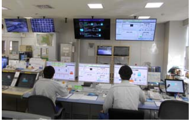
高野浄水場中央監視の状況
