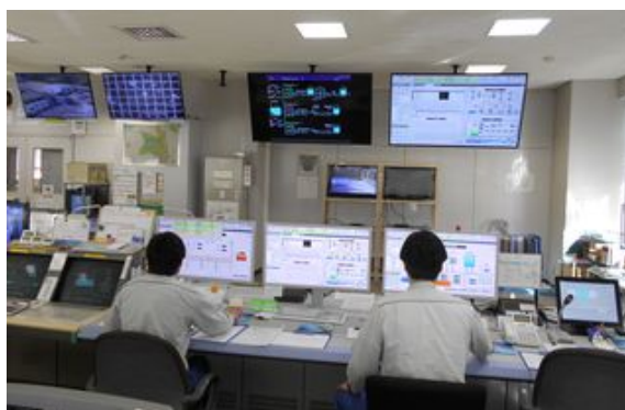
高野浄水場中央監視の状況
