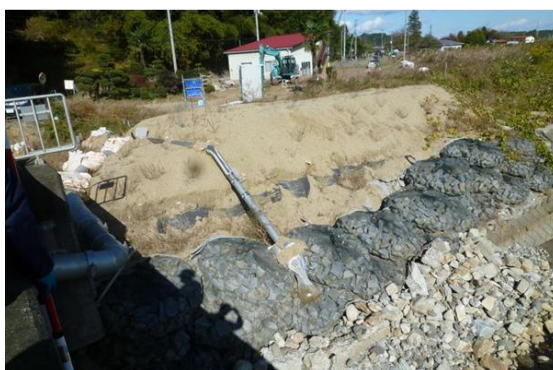
台風第19号被災状況（丸森町）
