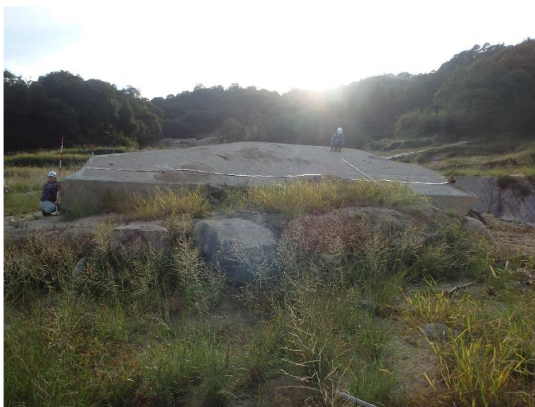
図.4 土石流で破壊され、流下した既設治山ダムの破片
