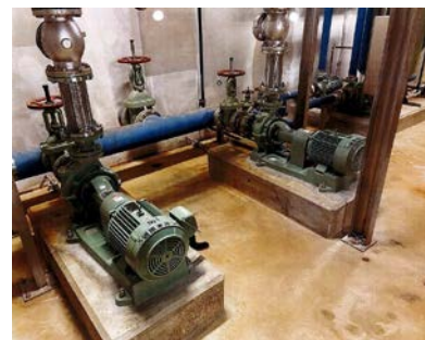
設備の整備、更新（ろ過原水ポンプ）
