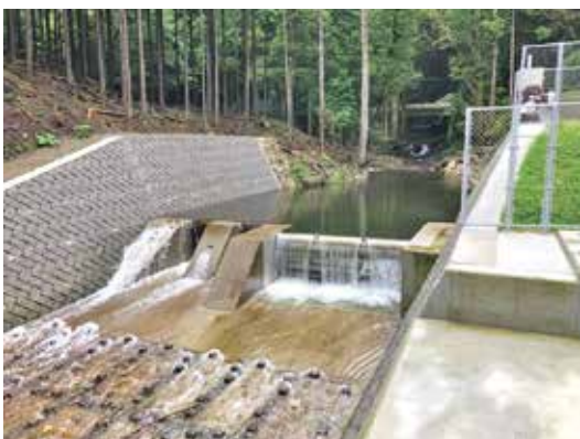
<馬野川小水力発電施設（取水口）>
