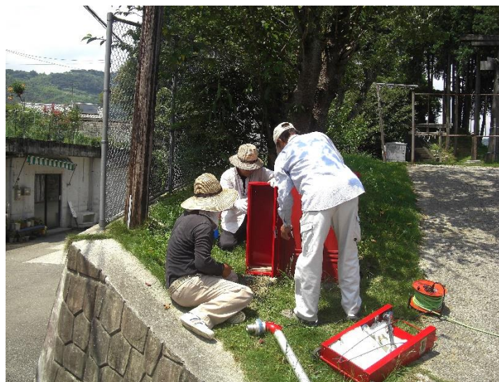
消火器設置16箇所
