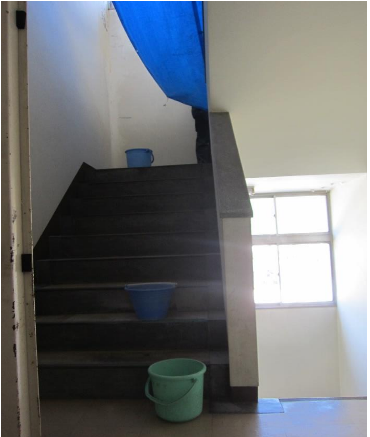
3階階段の漏水（尾鷲署）
