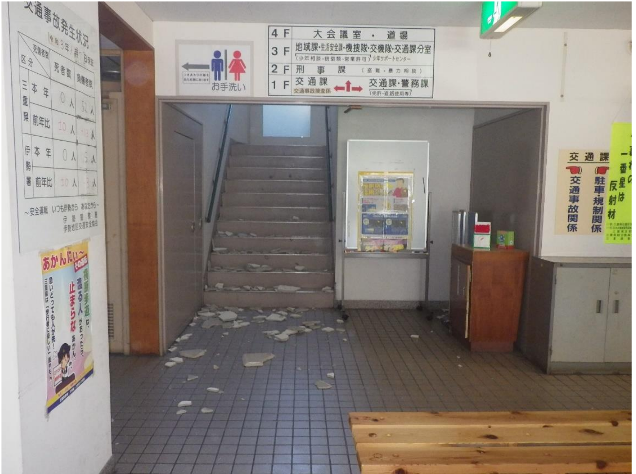
1階階段の天井剥落（伊勢署）
