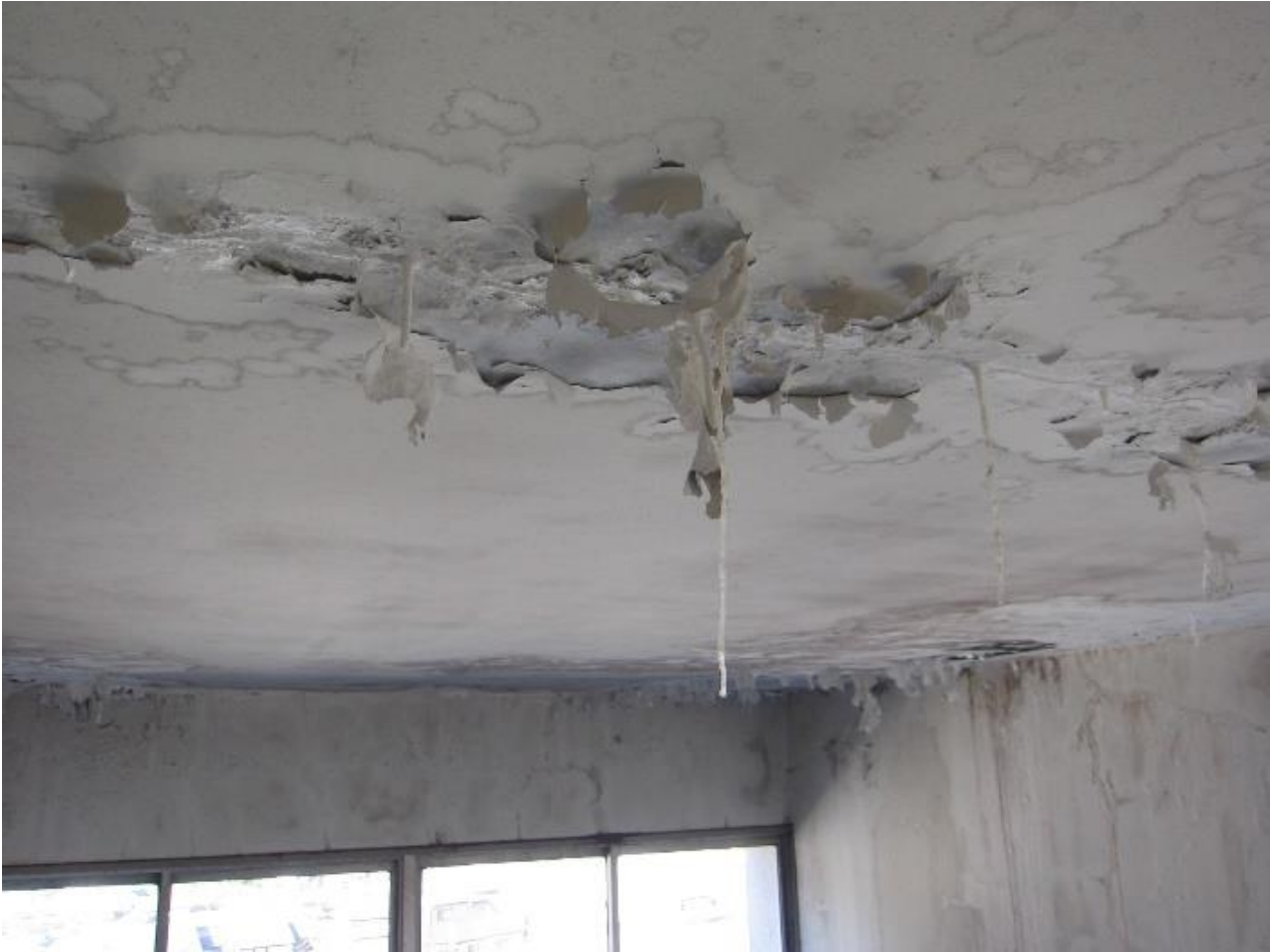
漏水箇所（尾鷲署）
