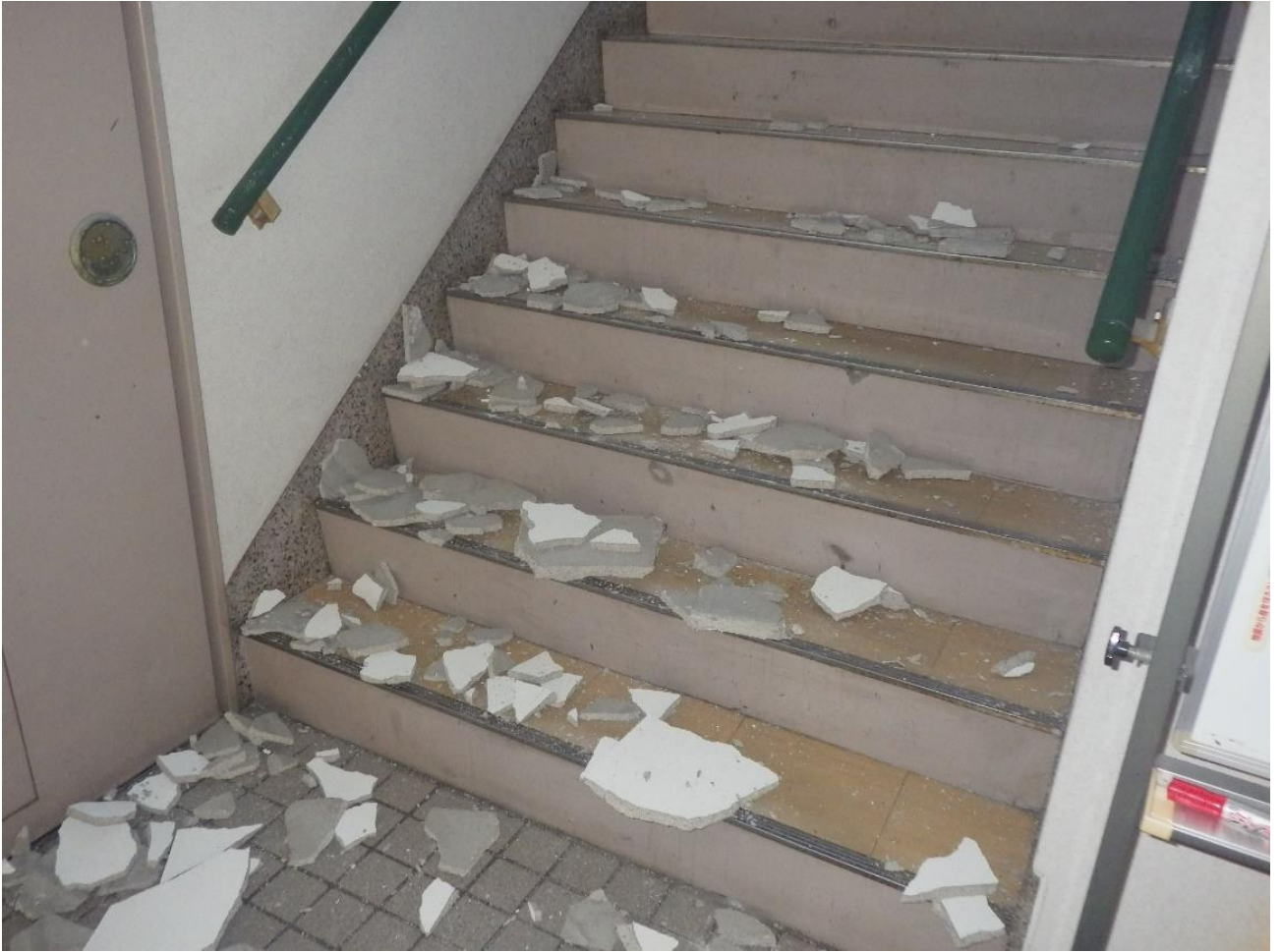
1階階段の天井剥落（伊勢署）
