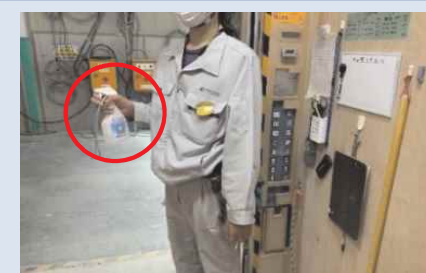
EVの操作盤等の消毒を徹底
