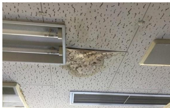
【管理研修棟における天井内水漏れの様子】
