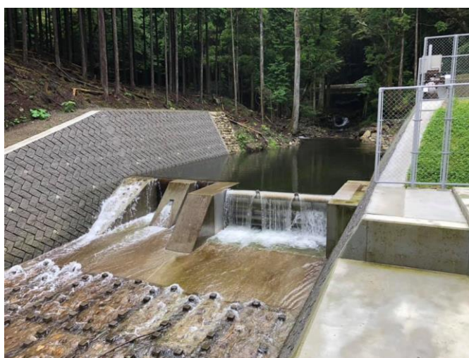
<馬野川小水力発電施設（取水口）>
