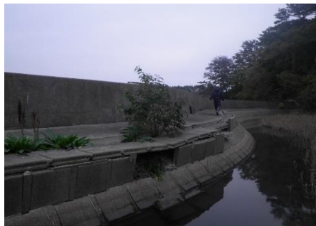
農地海岸の裏法被災状況
