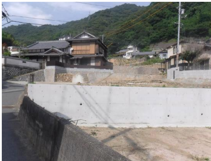
図2. 被災状況写真
