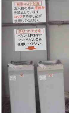
給水機では、フットペダルのみを利用
