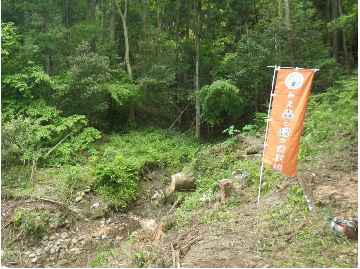
整備現場におけるのぼりの設置状況
