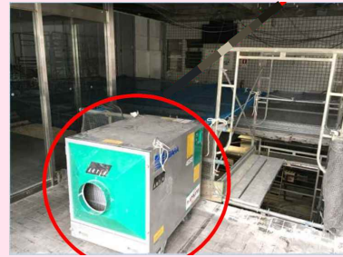
集塵機を設置し室内の換気を実施
