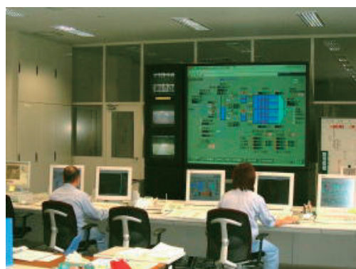
民間委託による運転監視
