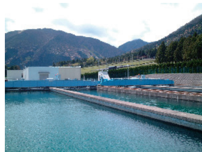
写真：北中勢水道 水沢浄水場
