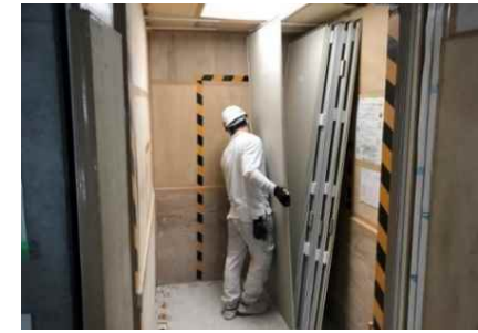
現場内の升降機を荷物専用として運用
