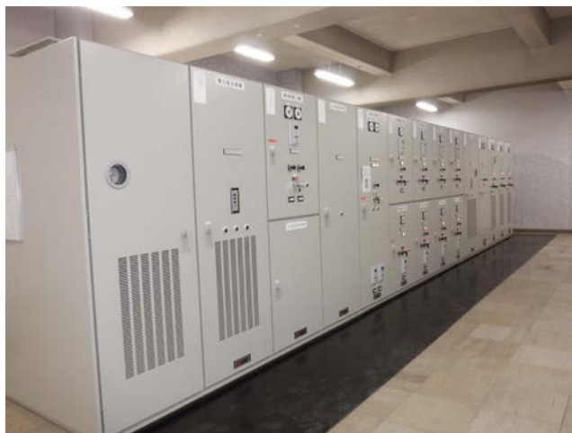
更新が完了した播磨浄水場の受変電設備 (令和元年度完了)
