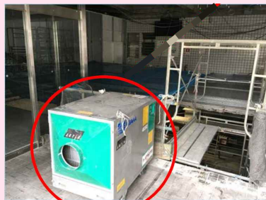
集塵機を設置し室内の換気を実施
